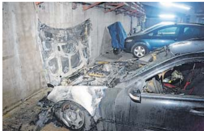
Ausgebrannt: Offensichtlich war der Brand im Motorraum des Mercedes-Kombi ausgebrochen. Über dem Stellplatz befinden sich Versorgungsleitungen, die beschädigt wurden. FOTO: ANDREAS EICKHOFF
